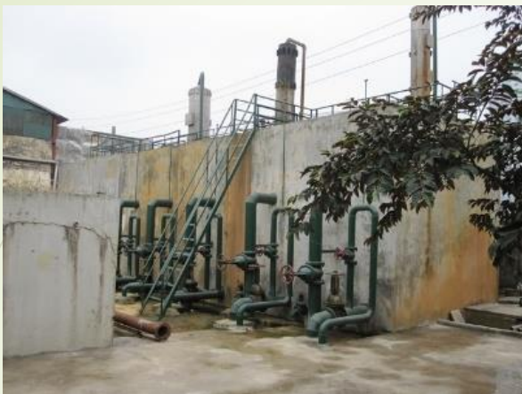
CƠ SỞ CẤP NƯỚC
